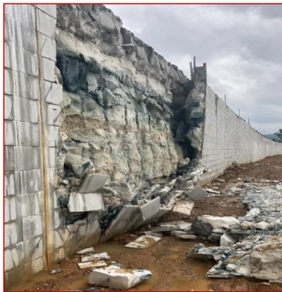
(a) 挂板整体倒塌
