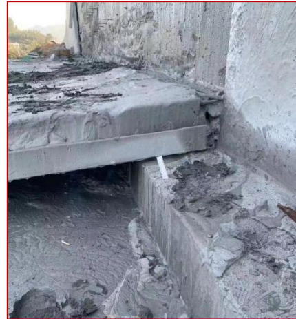
(b) 薄壁墙倒塌
